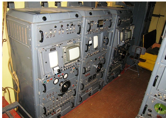
Vnitřek kabiny UV
